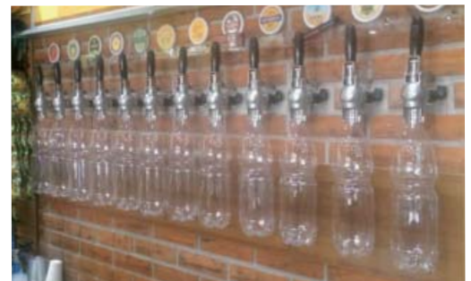
Installationsbeispiel in Beershop
